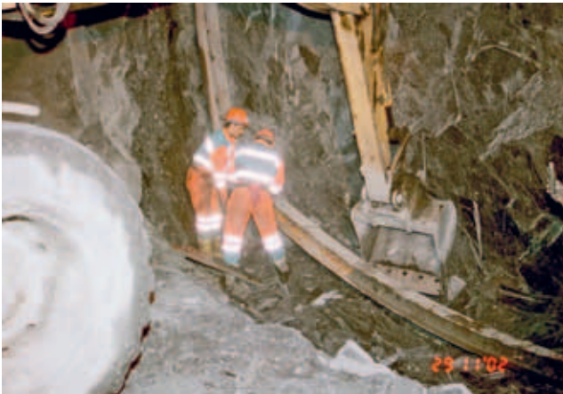
Fig. 8-13, oben: Kontakt Altkristallin (links) / Karbon (rechts); unten: Durchörterung Karbon: Einbau des Sohlsprengrers.
