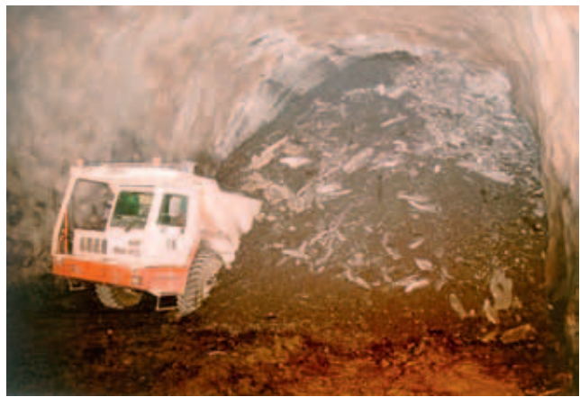
Fig. 3-12: Verschütteter Dumper im Karbon von Ferden (Fensterstollen Ferden, 4. März 2000).
