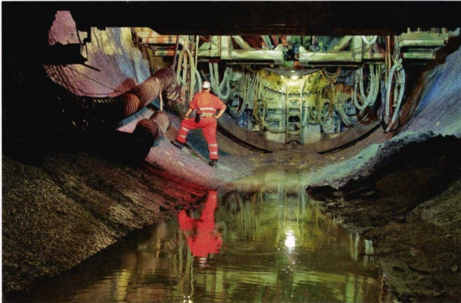
Wassereintritt bereitete den Mineuren Schwierigkeiten.
